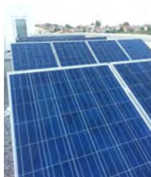
IL NUOVO impianto fotovoltaico è installato sulla copertura piana dell'edificio e fornisce energia solare gratuita a entrambi gli appartamenti
